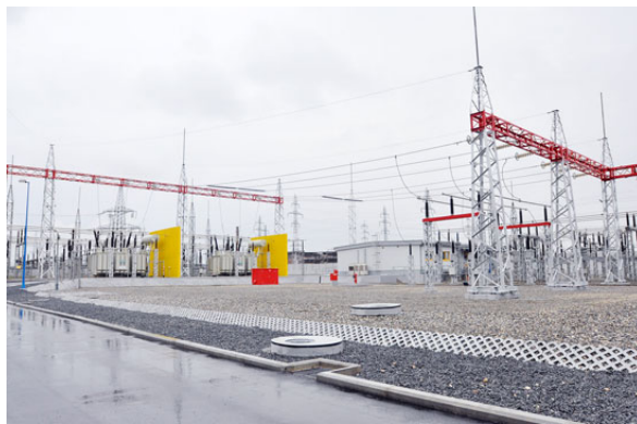
Şəkil 1. Sumqayıt İstilik-Elektrik Mərkəzi
